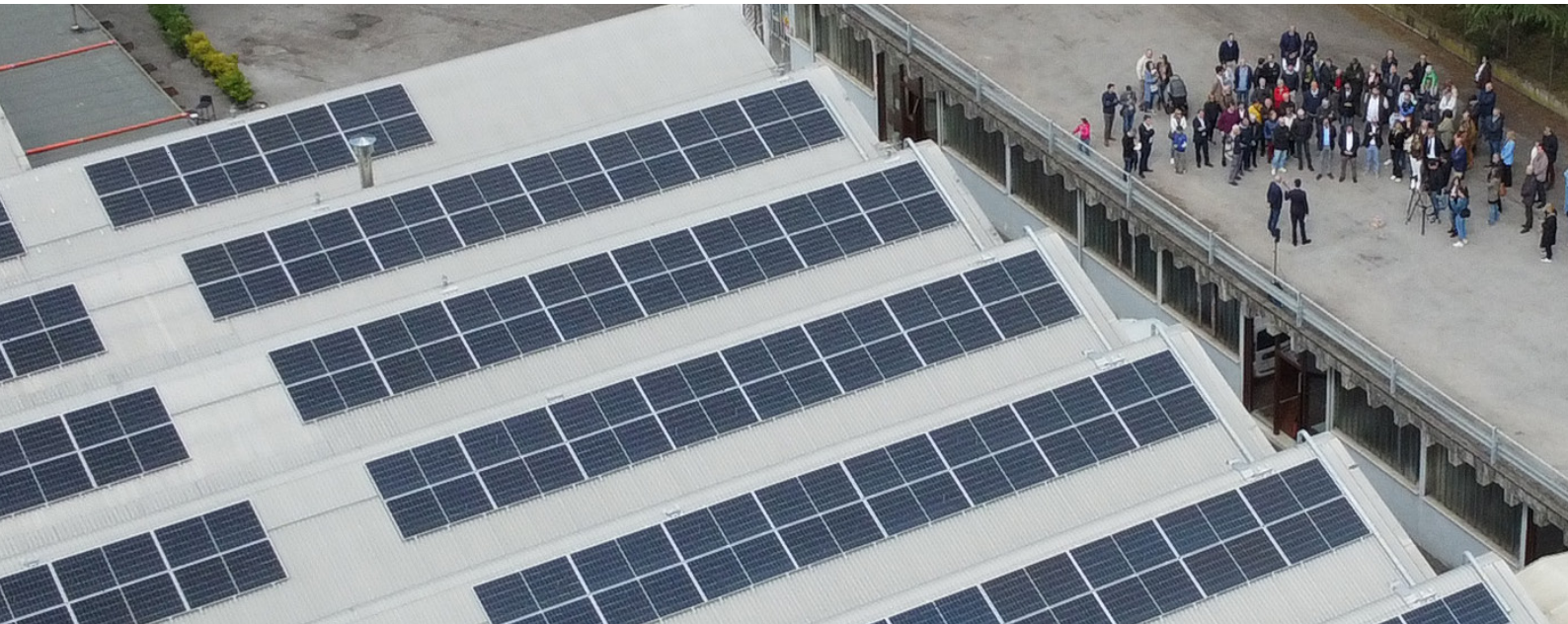
Impianto Carrera - Veneto (tetto)
